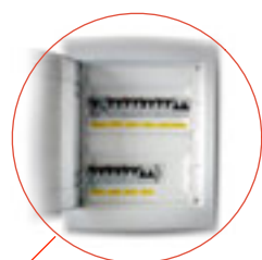
DIN rail panel
